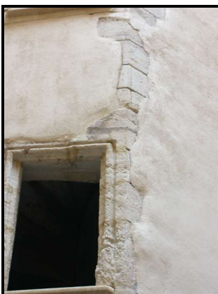
Enduit appliqué façon « dégradée », phénomène de harpage trop exagéré, qui efface toute la nervosité et la précision de l'architecture ...
