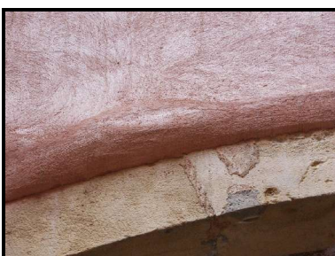
Surépaisseur de l'enduit qui aurait dû venir « mourir » sur la pierre...
